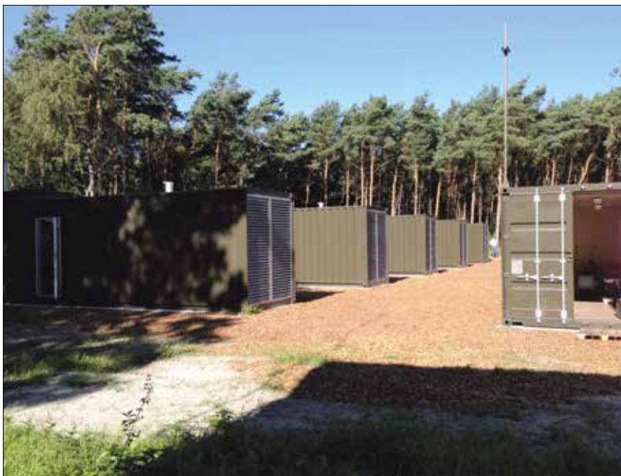
Generatoranlæggene er placeret i fem 40 fods High Cube containere på Vanggård.
